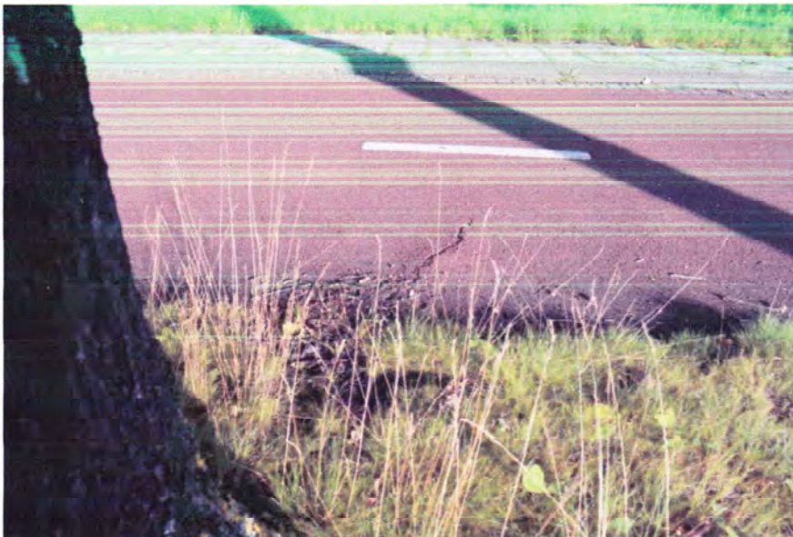
Foto 6 Gescheurd asfalt nabij stamvoet
